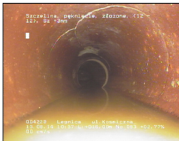
Foto 083 Wideo: CD1 Stan BAB B C 16,00 m 12 - 12 o'clock Szczelina, pęknięcie, złożone, Szerokość = 3mm
