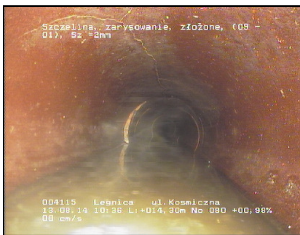
Foto 080 Wideo: CD1 Stan BAB A C 14,30 m 9 - 1 o'clock Szczelina, zarysowanie, złożone, Szerokość = 2mm
