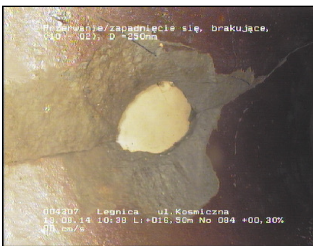
Foto 084 Wideo: CD1 Stan BAC B 16,50 m 10 - 2 o'clock Przerwanie/zapadnięcie się, brakujące, Długość = 250mm
