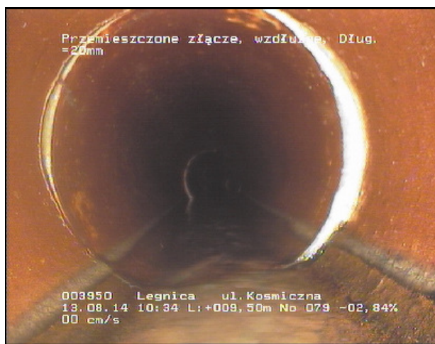
Foto 079 Wideo: CD1 Stan BAJ A 9,50 m Przemieszczone złącze, wzdłużne, Odległość = 20mm
