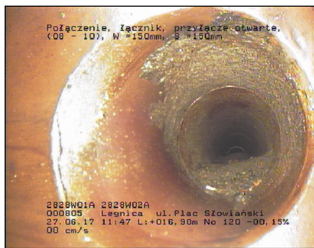
Foto 120 Video: CD1 Stan BCA A A 16,90 m 8 - 10 o'clock Połączenie, łącznik, przyłącze otwarte, Wysokość = 150mm, Szerokość = 150mm
