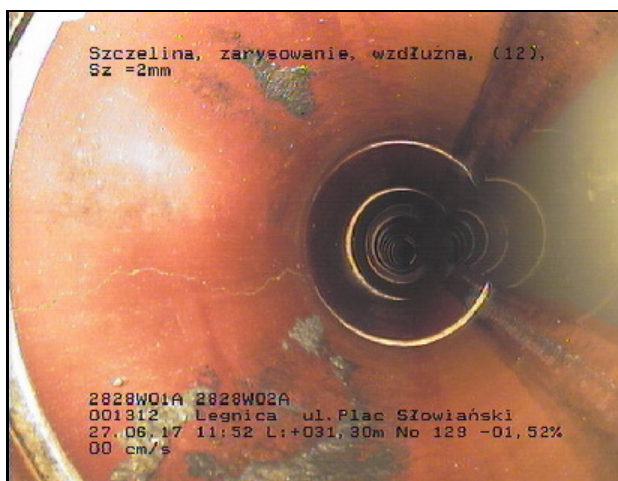
Foto 129 Wideo: CD1 Stan BAB A A 31,30 m 12 o'clock Szczelina, zarysowanie, wzdłużna, Szerokość = 2mm
